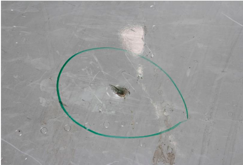
Figuur 22: Detail van de schampschade van het linkerpaneel
