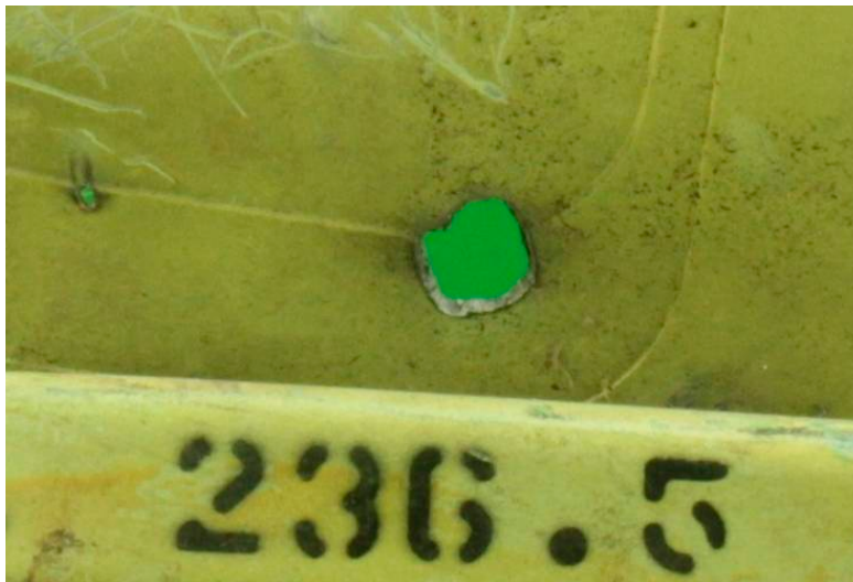
Figuur 4: Ponsschade (Bron: OVV)
